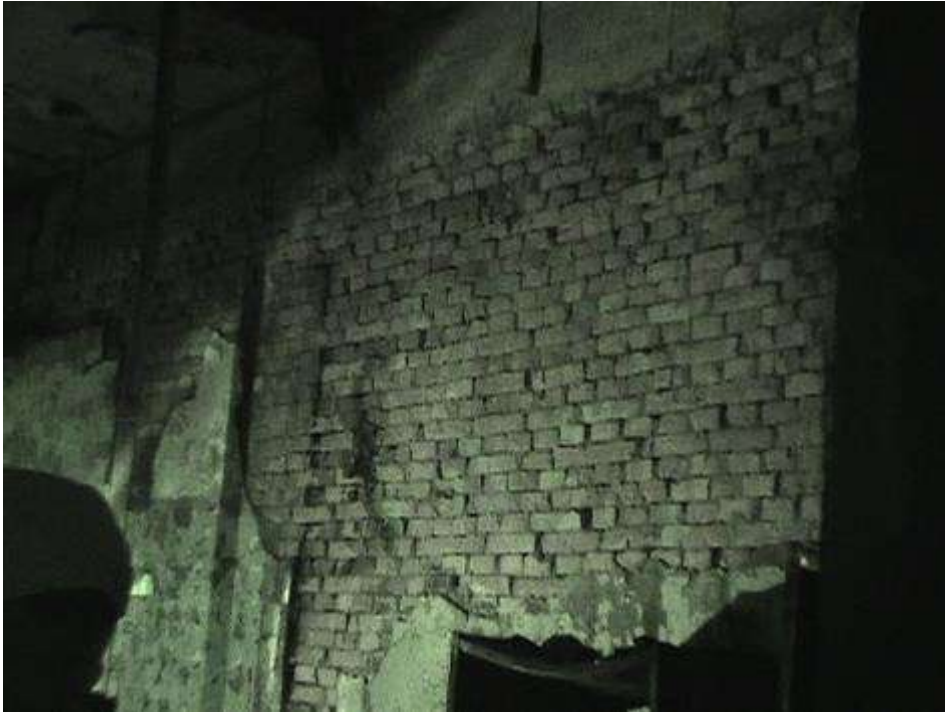
圖1 發生倒塌事故的化學儲藥木櫃位置牆壁
