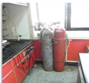
△ 氬氣鋼瓶接近電器插座，建議存放於防爆櫃內
